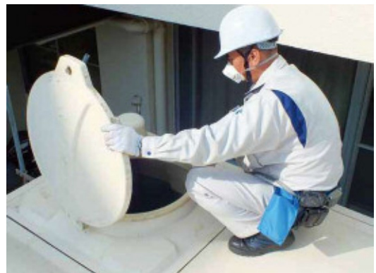
簡易専用水道検査
